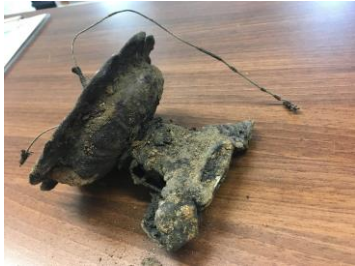
Ein Deckenlampenhalter mit Stromanschluss
